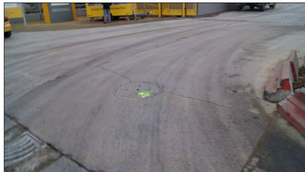
Foto: 4_1B, 00:00:00 0m, Beginknooppunt, inspectieput, lp 4
